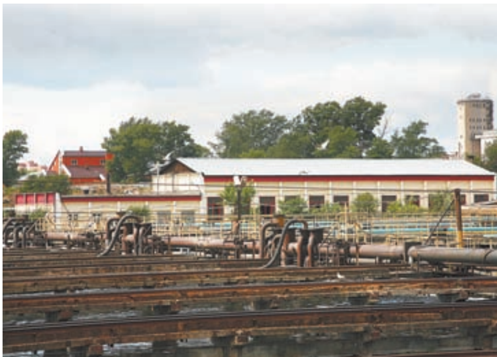
Вода, пройдя механические этапы очистки, подвергается тщательной обработке в специальных резервуарах – аэротенках, где осуществляется глубокая очистка от азотных и фосфорных соединений.
