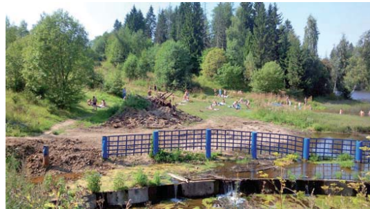
▲ После ремонта водосброса остался мусор
